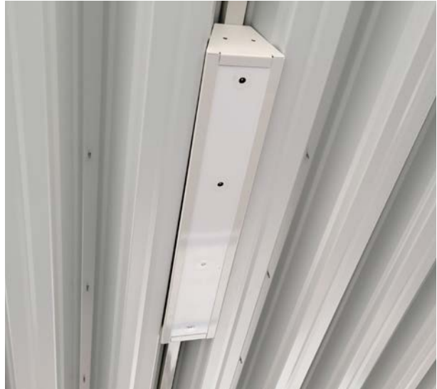
LED Leuchte im Trapezblech der Dacheindeckung
