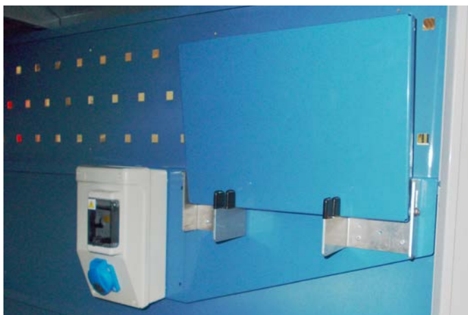
▲ Ladevorrichtung für Pedelecs an Gehäusewand montiert
