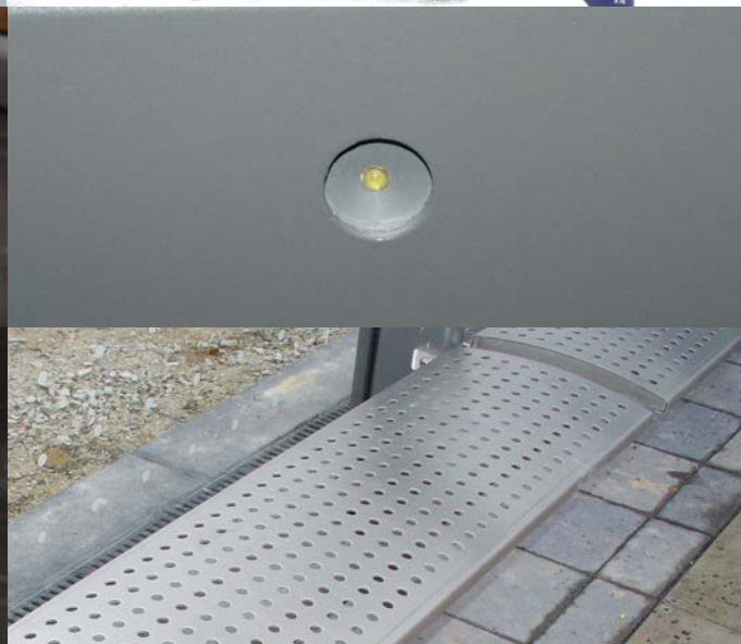
▲ LED Beleuchtung im Unterzug
